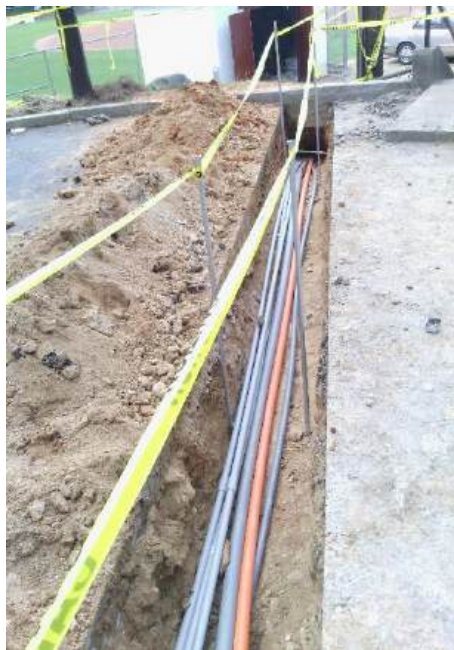
Druid Hills HS conduit
