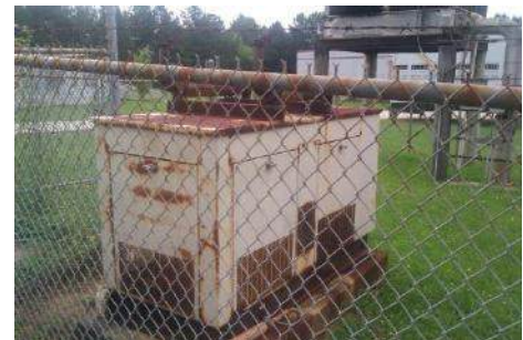
Browns Mill ES Generator
