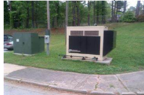
Jolly ES existing generator
