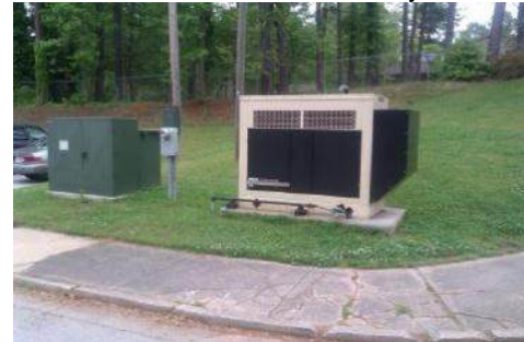
Jolly ES existing generator
