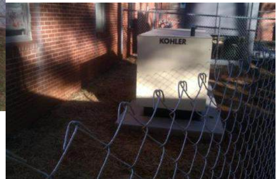
Chesnut ES New Generator
