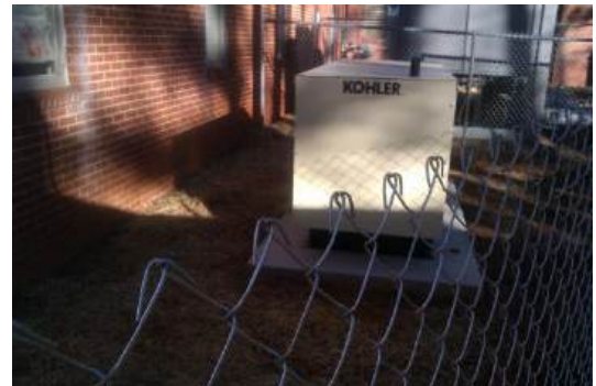
Chesnut ES New Generator
