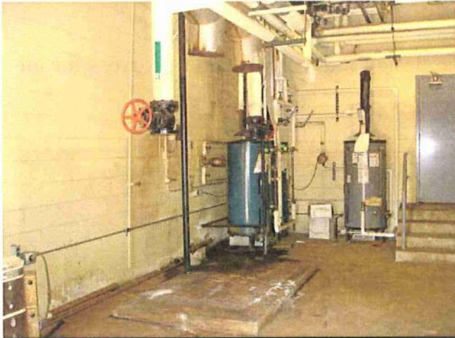
Avondale ES Existing Boiler Room
