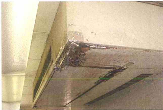
Redan ES Existing HVAC Unit
